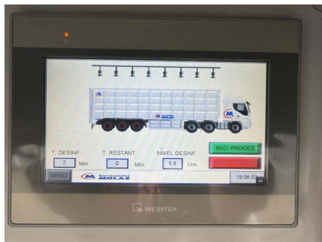
Foto 2. PLC del sistema de control
